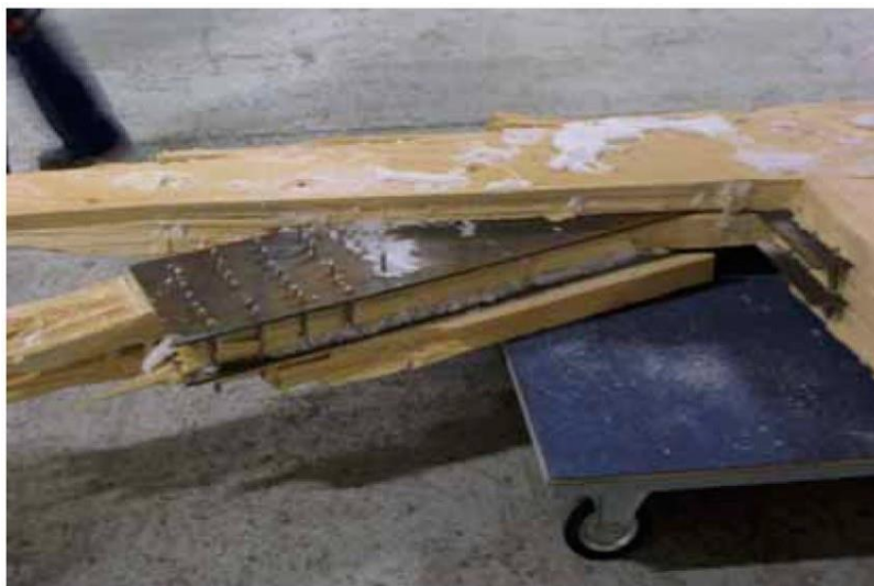
Зруйноване нагельне з'єднання
